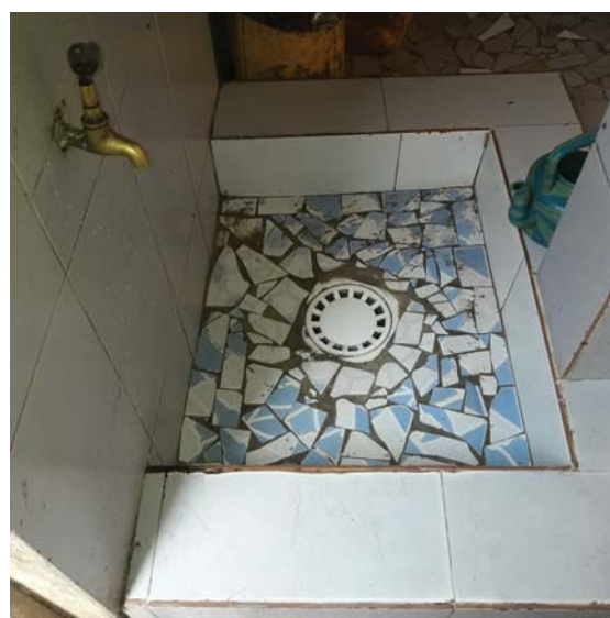
Robinet avec puisard, Branchement Particulier
