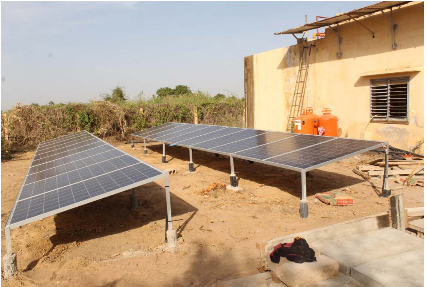
Station de potabilisation de Ndiakhar
